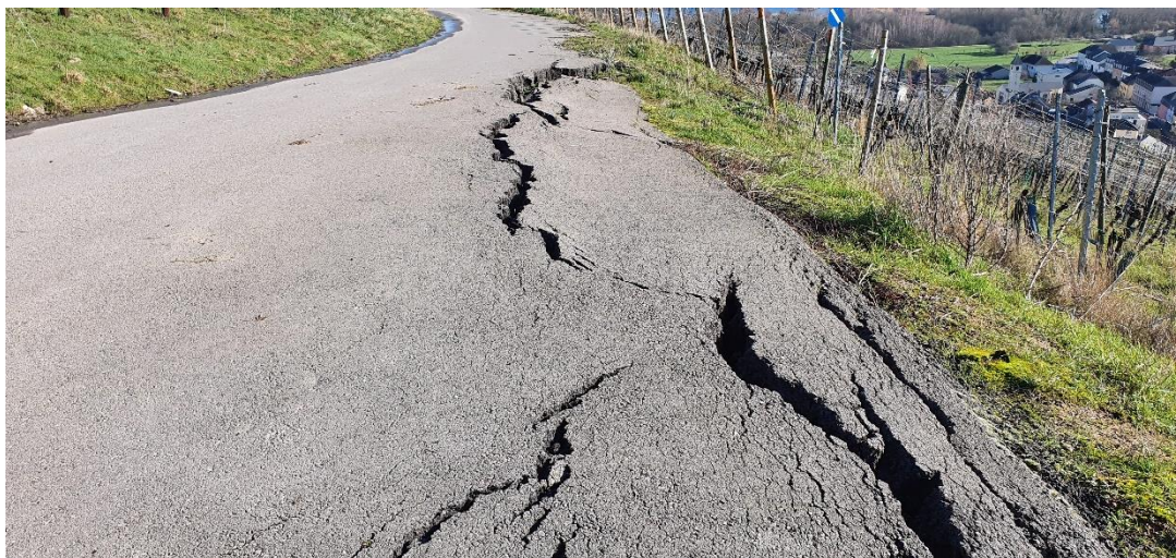
Abbildung 12: Rissbildung durch Untergrundsetzung in Wintringen
