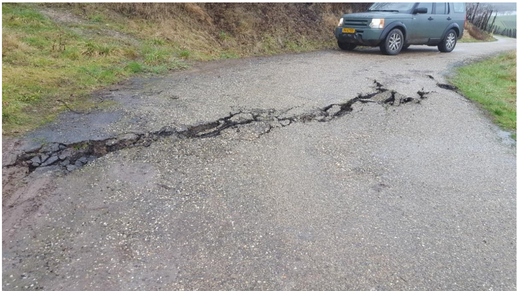
Abbildung 6: Ein durch eine Rutschung beschädigter Wirtschaftsweg in Stadtbredimus
