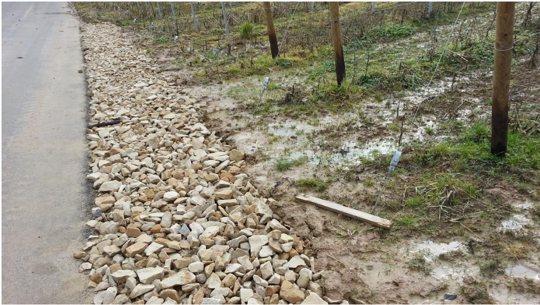
Abbildung 21: Drainagegraben mit Grobgestein bis zur Oberfläche
