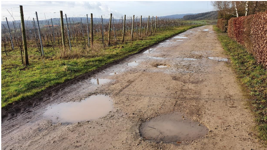
Abbildung 17: Schäden an nicht befestigtem Weg durch Wenden und erhöhte Verkehrsfrequenz
