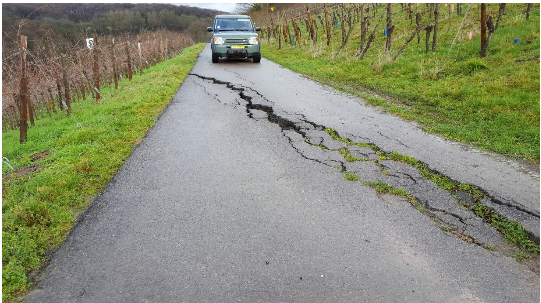
Abbildung 3: Durch Rutschung beschädigter Wirtschaftsweg in Wintringen
